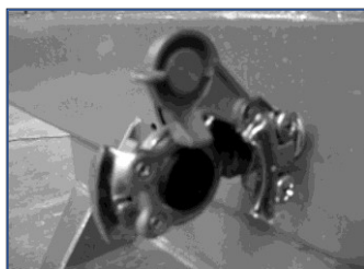
Abierto: Instalación desprotegida
